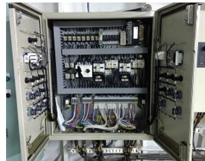
Control System 控制系统
